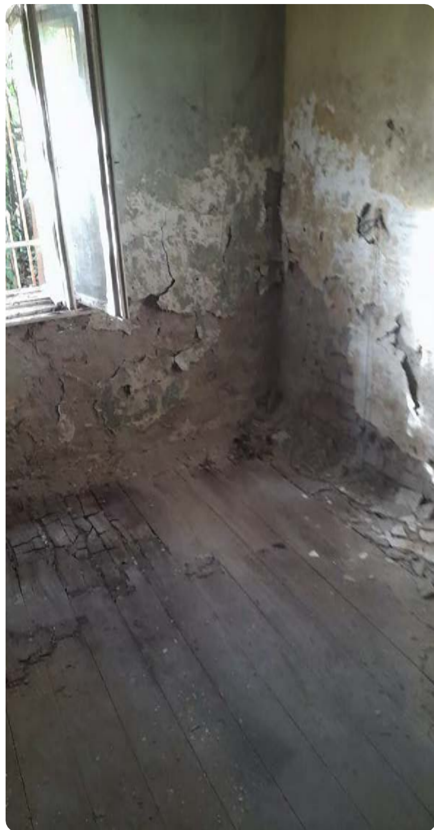
átnedvesedett falak, tönkrement padló
