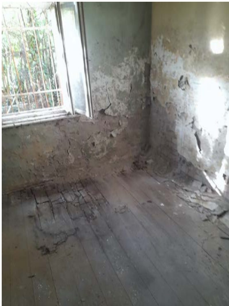
Tönkrement, korhadt padló, átnedvesedett falak
