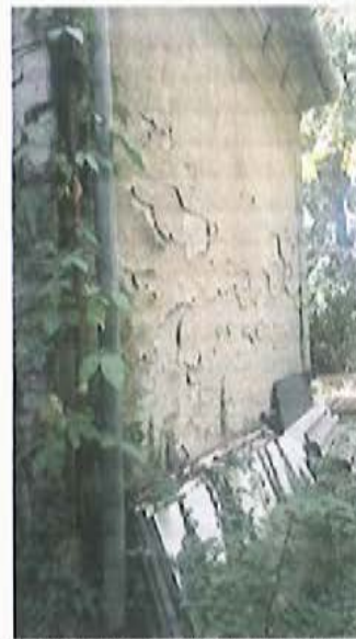
7. É-i homlokzat - felázott fal, málló vakolat
