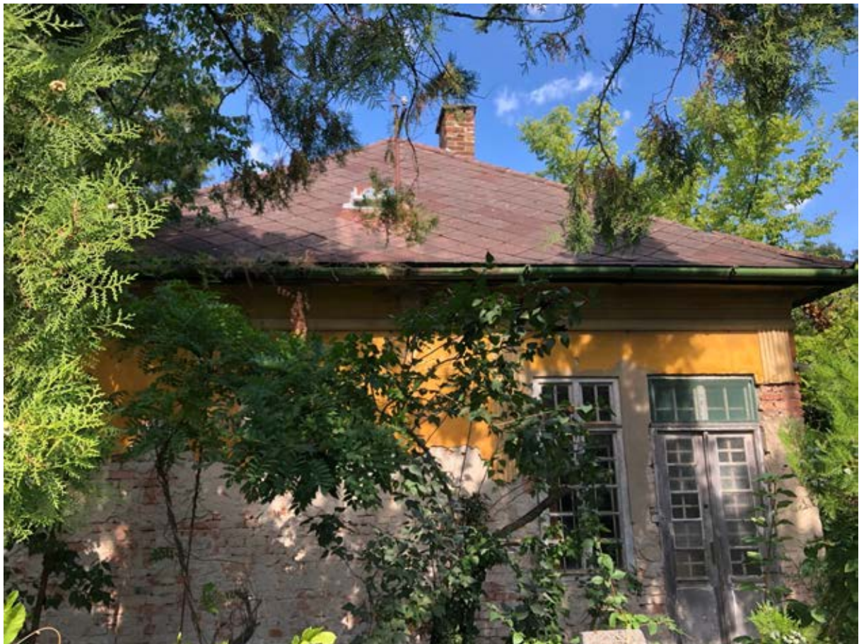
Déli homlokza - látható a rossz állapotban lévő épület és az azbeszttartalmú műpala fedés
