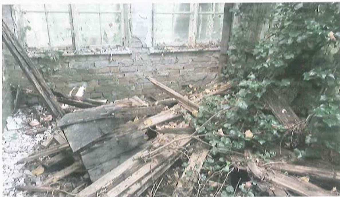
13. K-i (bátsó) homlokzat - málló vakolat, beomlott épületszárny
