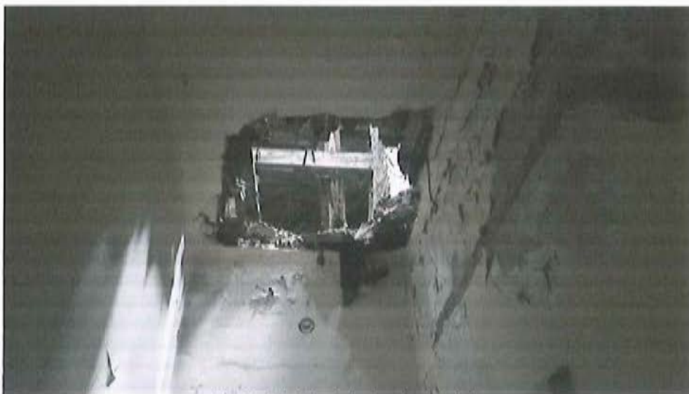
19. Közlekedő korhadt, beszakadt fa födém
