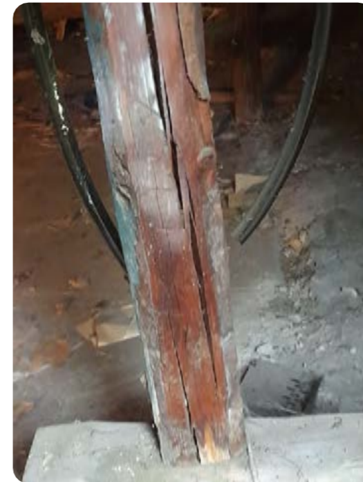
fedélszék hosszanti repedésekkel
