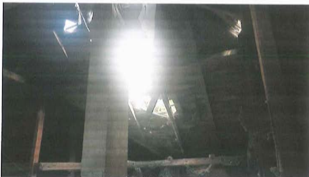
23. Beszakadt bégálás, károsodott fedélszék
