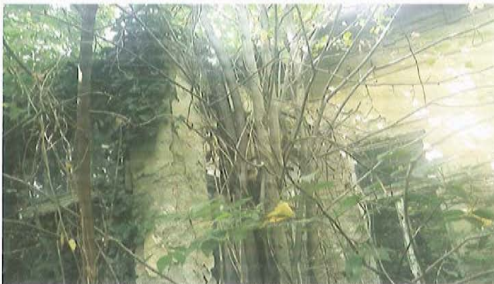
8. K-i (hátsó) homlokzat - málle vakolat, beomlott épületszárny
