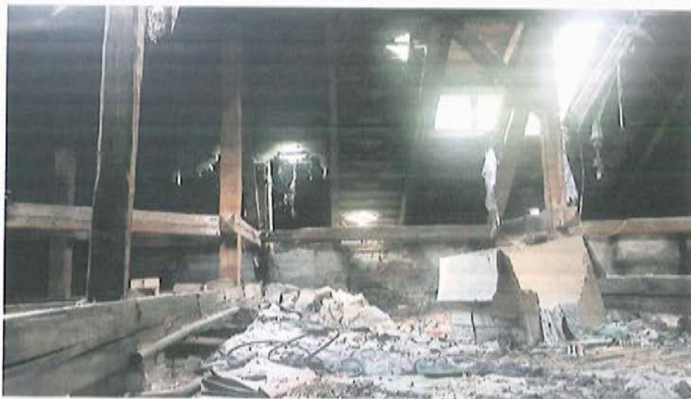
26. Berzakadt héjalás, károsodott fedélszék
