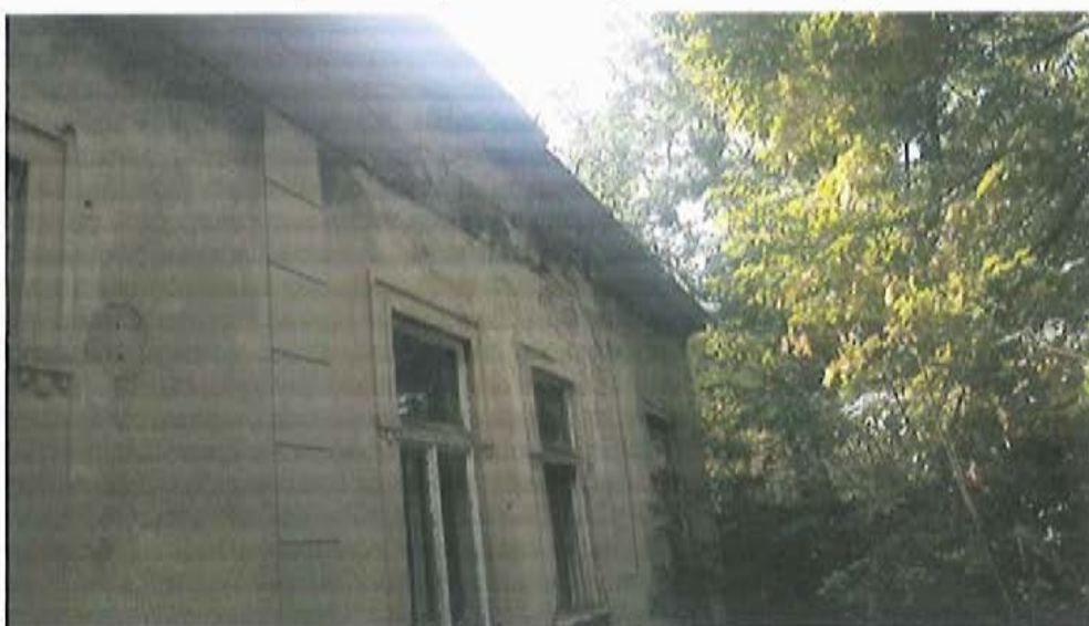
3. Utcafronti homlokzat - korhadt ereszt és tetőt, mállo homlokzati fal
