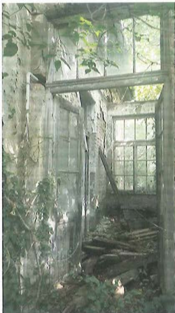
11. K-i (bátsó) homlokzat - málló vakolat, beomlott épületszárny
