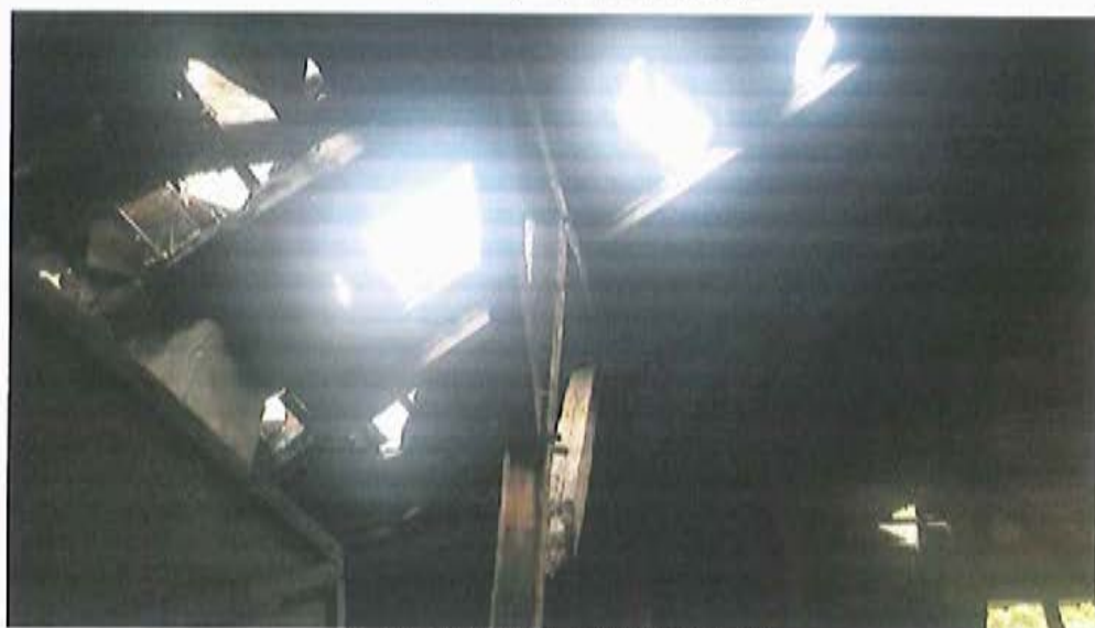
25. Beszakadt bégálás, károsodott fedélszék
