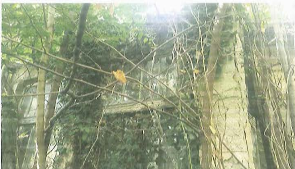
9. K-i (hátsó) homlokzat - málle vakolat, beomlott épületszárny
