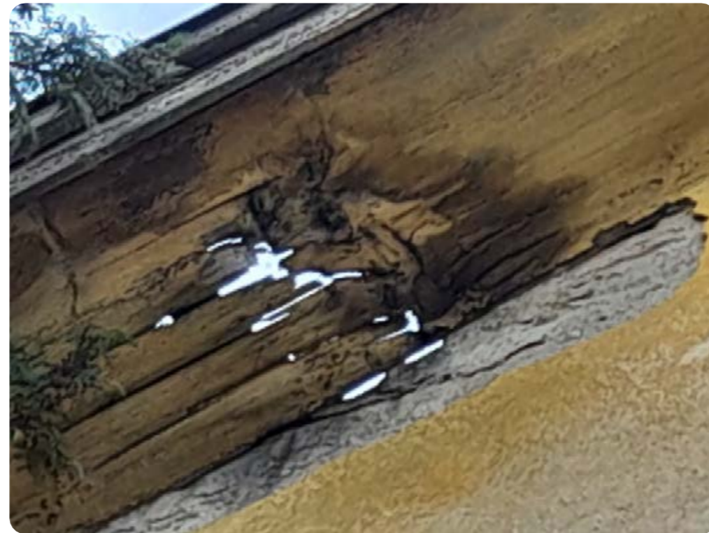
átázott, átlukadt ereszalja
