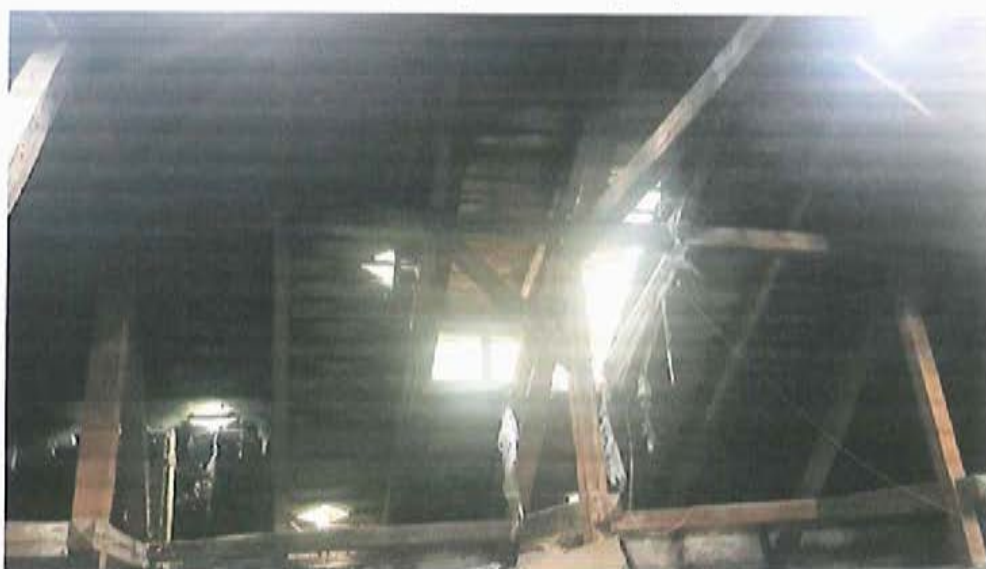
24. Beszakadt bégálás, károsodott fedélszék
