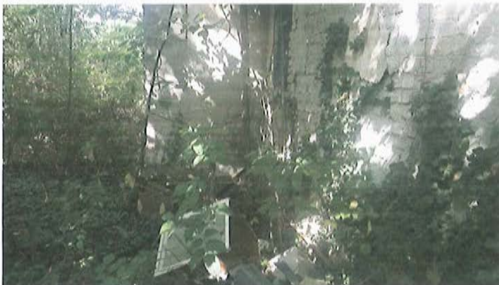
14. D-i homlokzat - felhúzott, málló vakolat
