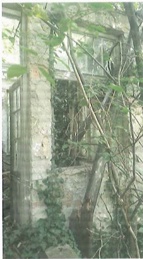
12. K-i (bátsó) homlokzat - málló vakolat, beomlott épületszárny
