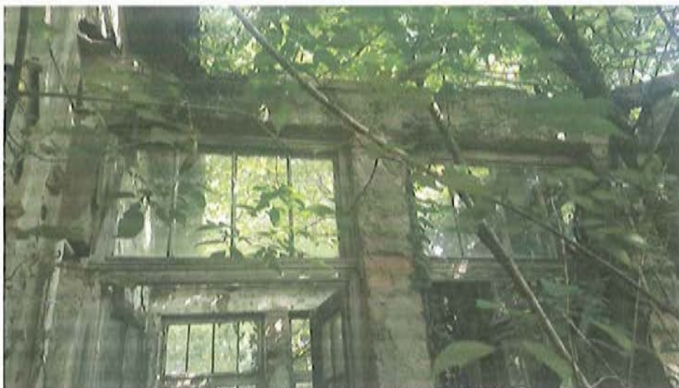
10. K-i (hátsó) homlokzat - málle vakolat, beomlott épületszárny
