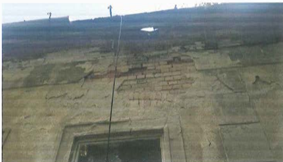
2. Utcafronti homlokzat - korhadt ereszt és tetőt, mállo homlokzati fal
