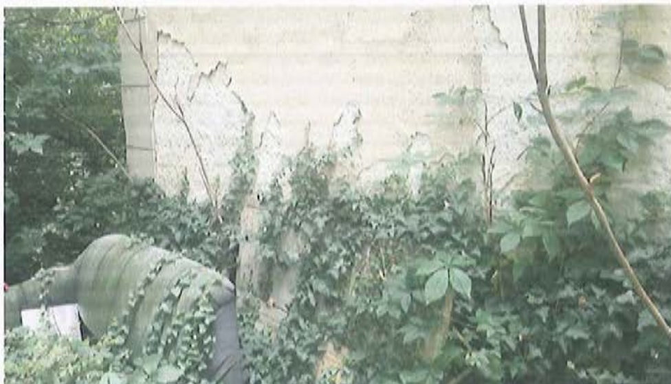
5. É-i homlokzat - felázott fal, málló vakolat
