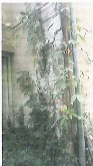
6. É-i homlokzat - felázott fal, málló vakolat
